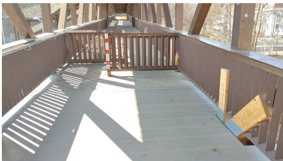
Abbildung 3-6: Im Jahr 2013 eingebauter Alubelag im Bereich der östlichen Rampe bis vor die Umlaufsperrre
