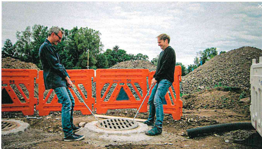
Abb. Bauarbeiten für die Klangskulptur. Die beiden Gullys wurden eigens für „Zusammen Fluss“ angelegt. Hier ist das Künstlerduo Enrico Stolzenburg (links) und Daniel Ott (rechts) zu sehen. © Markus Oppenländer
